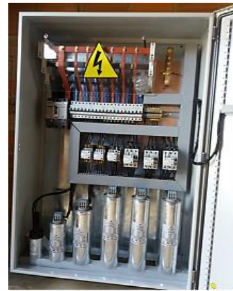
Figura 6. Vista interior del banco de condensadores. Crédito: C.Mendoza C.
